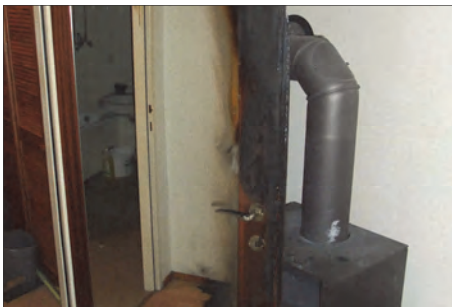
10.03.2015 Holzofen entzündet Zimmertür
