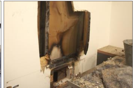
20.10.2018 Brand in Zwischenwand rechtzeitig entdeckt
